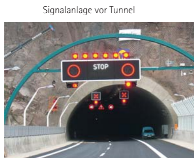
Signalanlage vor Tunnel
