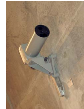
Rauchmessung und Brandmeldeanlage
