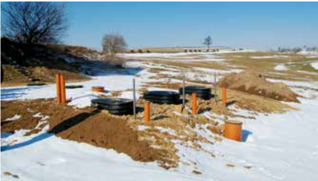
Gruppenkläranlage Altenhof (AZV Leisnig)
