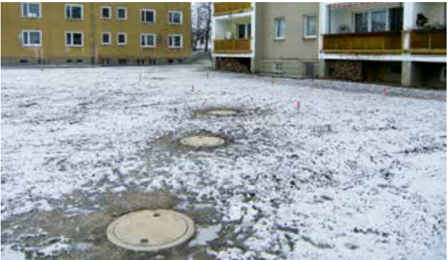
Gruppenkläranlage AZV Oelsabachtal
